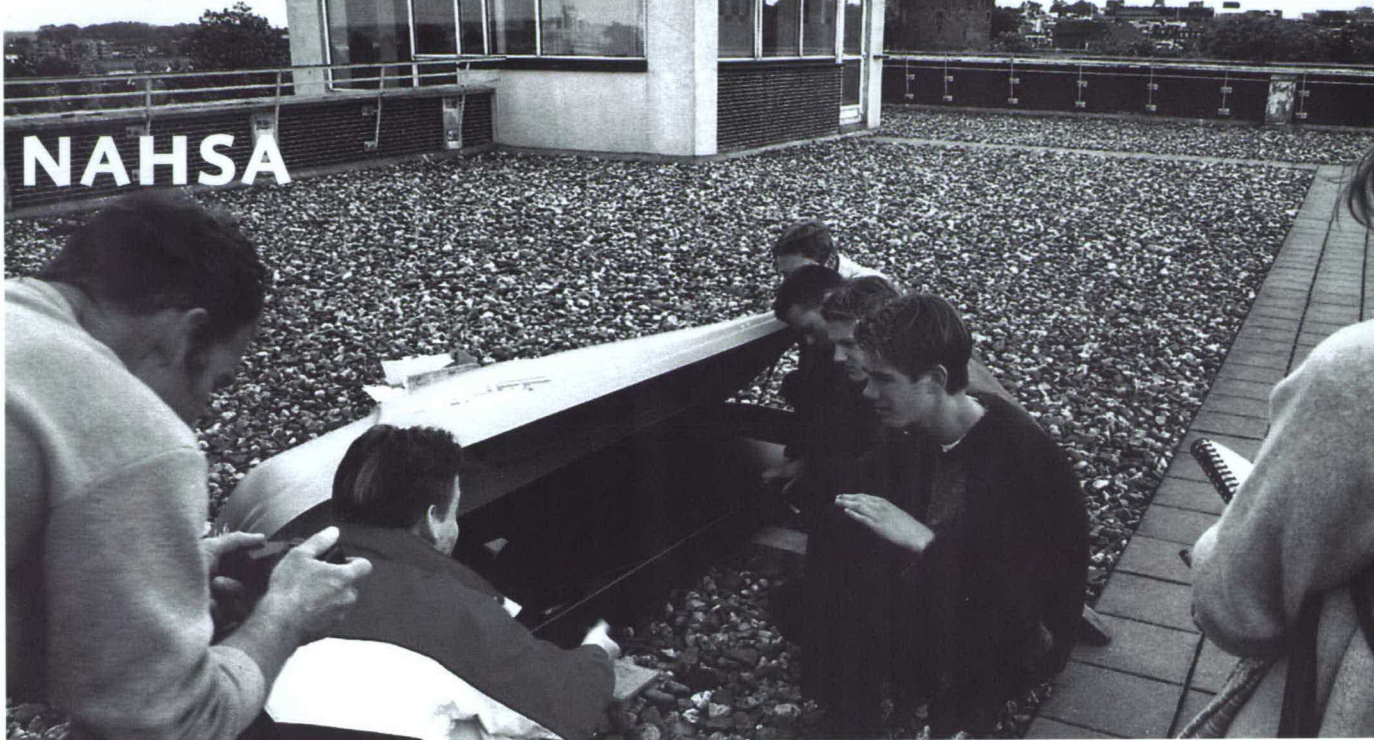
Figuur 4 Installatie van een detector op het dak van het Stedelijk Gymnasium in Nijmegen.
